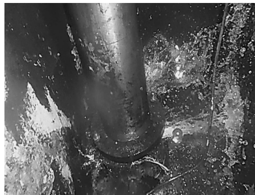
Figura 3. Fuga de agua por los muñones de los álabes. Fuente: Foto tomada en central hidroeléctrica Alto Anchicayá. Autores.
